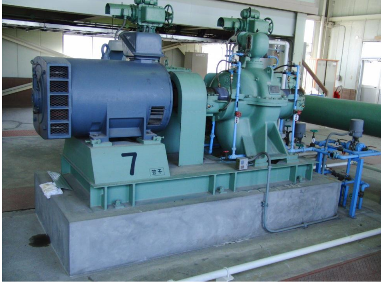
船穂揚水機場 揚水ポンプ
